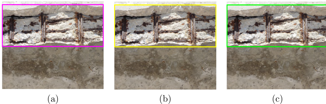
FIGURE 1.2 – Un exemple de défauts qui se chevauchent au même endroit : (a) Écaillage ; (b) Corrosion ; (c) Barres exposées [58].
