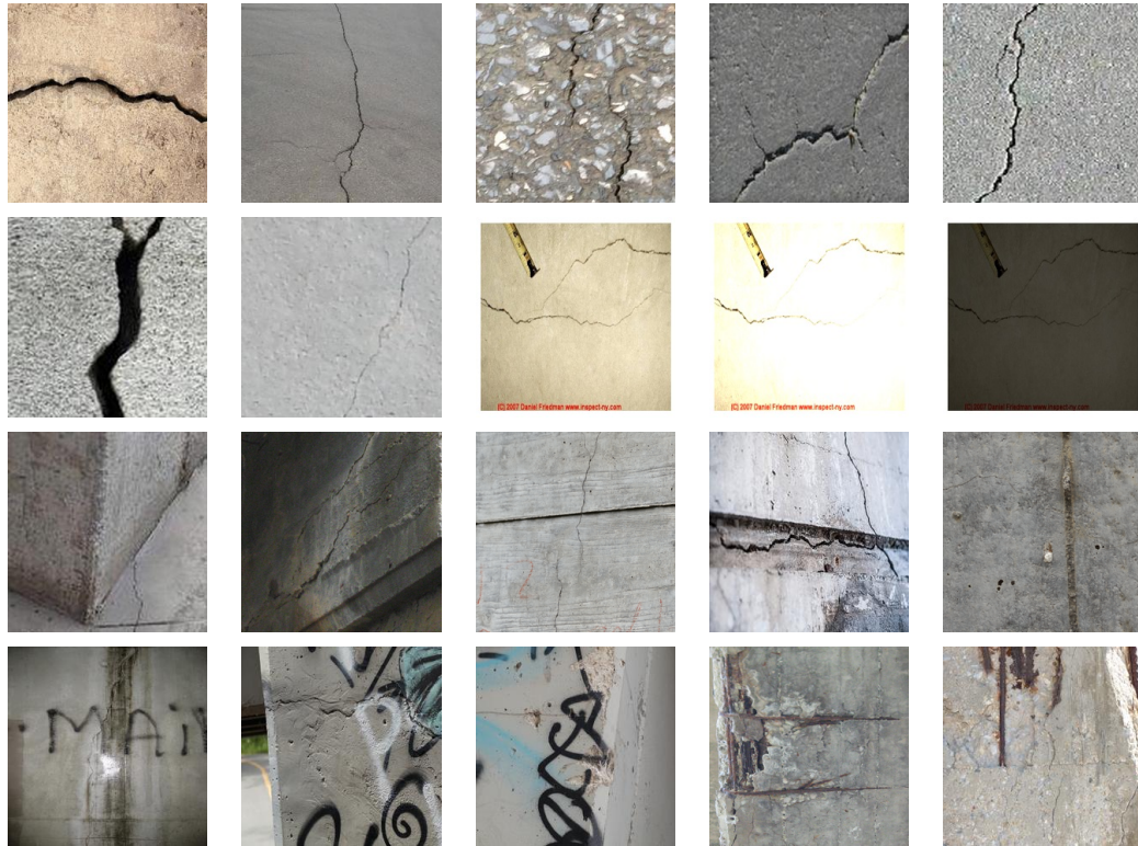
Figure 4.1: Illustration des défis de visibilité et de segmentation des fissures. La première rangée montre des fissures illustrant la nature hétérogène du béton, avec une texture non uniforme qui peut masquer les fissures. La deuxième rangée commence par une fissure très sévère (épaisse), suivie d'une fissure subtile, et montre ensuite une fissure différente sous trois conditions : normale, très lumineuse et faible luminosité. La troisième rangée représente des fissures avec des structures linéaires comme des joints, mettant en évidence le défi de distinguer les fissures des autres caractéristiques linéaires. La dernière rangée comprend des fissures obscurcies par de la saleté ou des graffitis, entraînant des faux positifs ou des détections manquées, et des fissures chevauchées par d'autres défauts.
