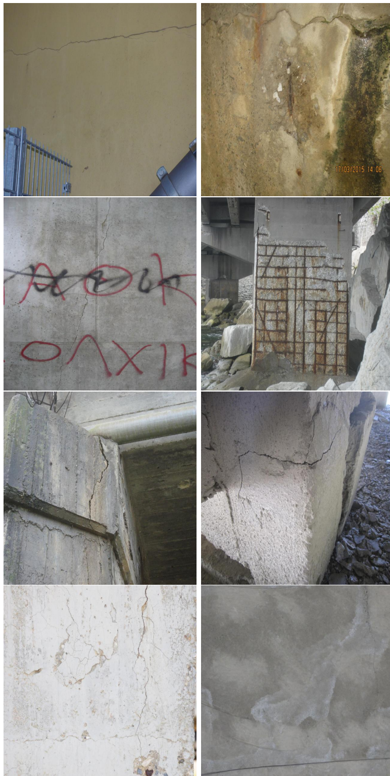
Figure 1.3: Défis de la détection des fissures sur les surfaces en béton à différentes distances.
